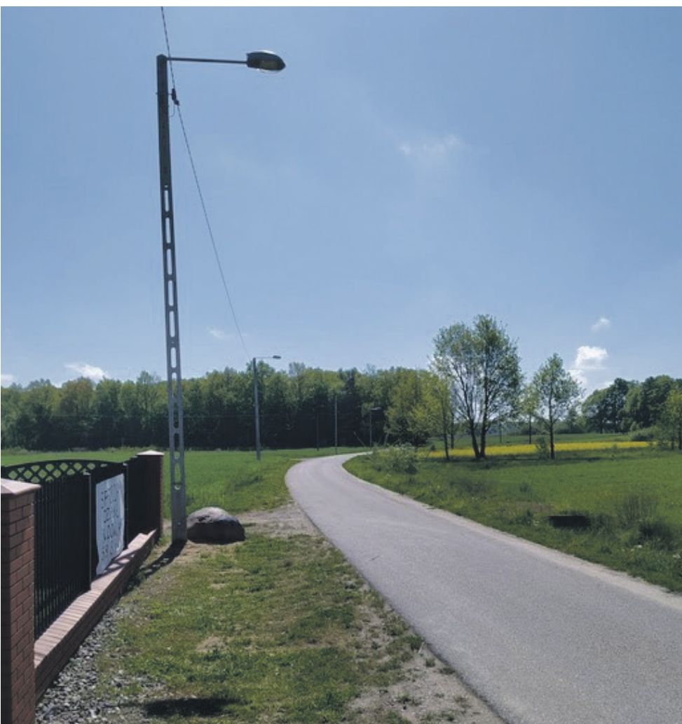
Oświetlenie ulicy Podgórskiej w m. Romanów (Stawki)
