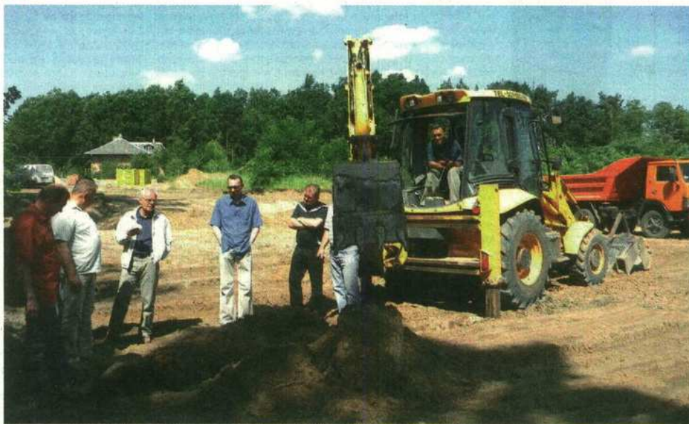
Trwają prace budowlane w Kosowie. Będą tam świetlica wiejska i boisko wielofunkcyjne.
