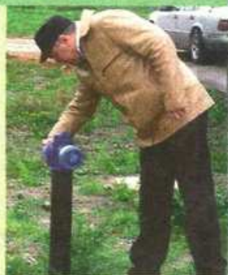
Piotr Markiewicz, kierownik Referatu Inwestycji w Urzędzie Gminy w Kowali, sprawdza czy hydrant jest dobrze zamontowany.
