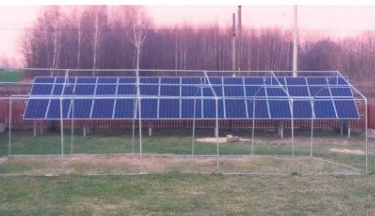
Instalacja fotowoltaiczna w Domu Pamięci Kotlarza
