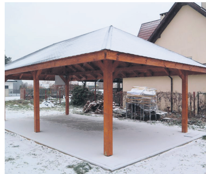
Budowa wiaty rekreacyjnej (altany) w sołectwie Zenonów gmina Kowala” zadanie współfinansowane ze środków Samorządu Województwa Mazowieckiego.
